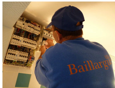
Câblage et électricité
